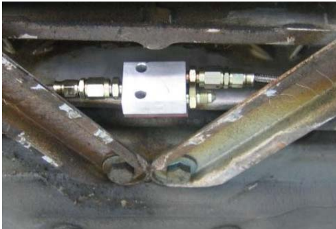
Verteiler geklebt / T-splitter adhere
